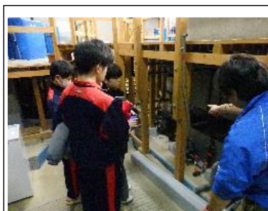
図Ⅲ－2－49 おさかな館バックヤードの水質浄化装置
