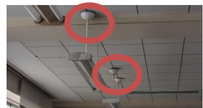
写真2. 照明器具の劣化
