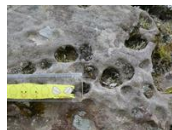
図2 石垣に見られる侵食
